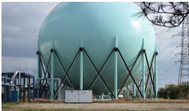
Фигура 2. Системата за укрепване на този резервоар за LPG беше подсилена след земетресението и цунамито през 2011 г. в Източна Япония (Снимка: Е. Краусман)
